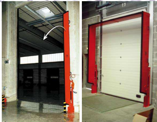
*Barrière automatique à déclenchement sur sprinklage.
